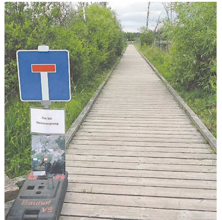
Aufgrund eines Schadens an einem Moossteg, müssen die Besucher des Naturschutzgebietes einen Umweg in Kauf nehmen. Die Reparatur des Steges ist bereits in Auftrag gegeben. Foto: Stadt Villingen-Schwenningen
